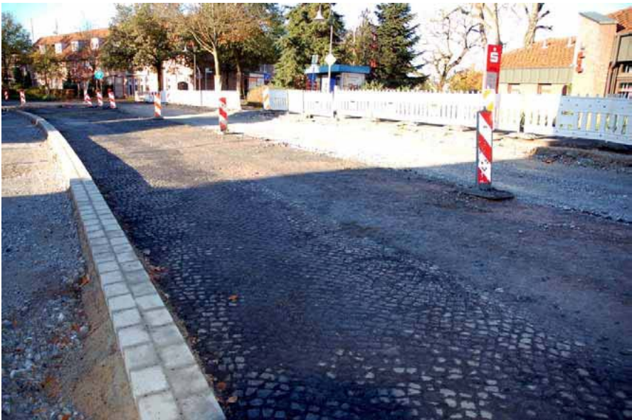
Bauarbeiten an der Detmolder Str./Ecke Im Vogtland vom 27.10.2013 Foto von Ralf-Peter Fietz
